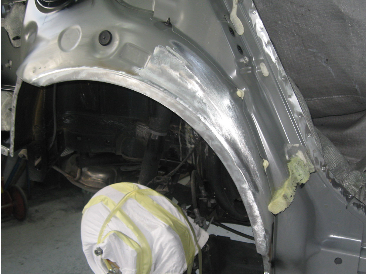
Bild: Nach dem Austrennen kann der Radkasten einwandfrei ausgebeult werden. Die Aufnahmepunkte der Seitenwand passen perfekt (Bild Fückiger)
